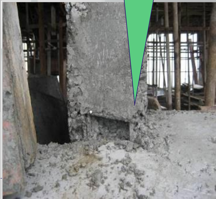
短支墙根部漏振、烂根、露筋
