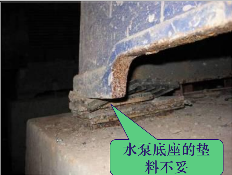
所有水泵安装时，均未采用垫铁，仅用橡胶隔振垫
