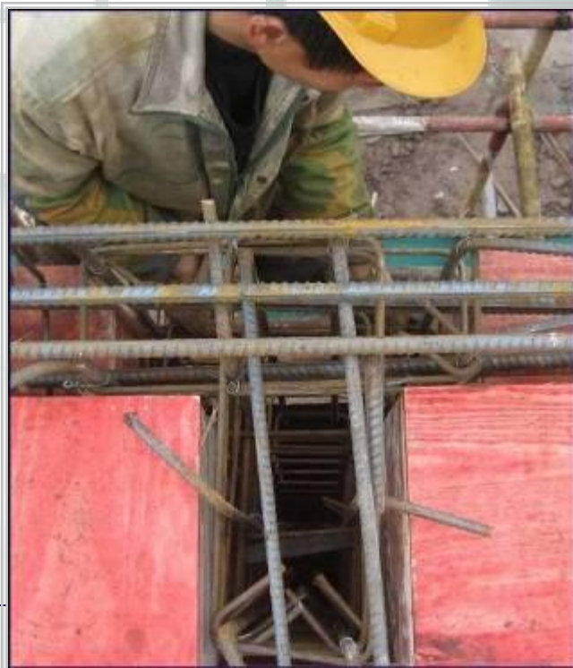
钢筋安装错误
